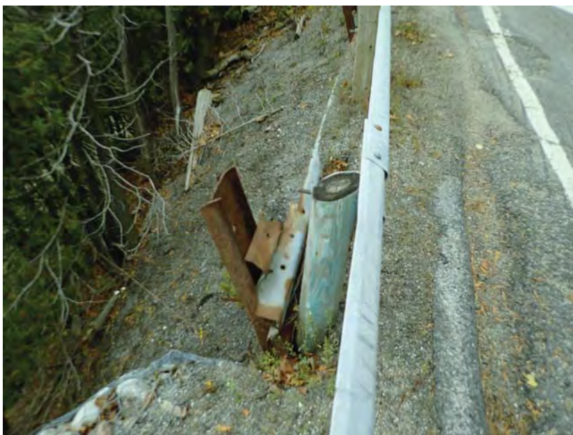
Figure 3 : Érosion à la jonction des sections 1 et 2
