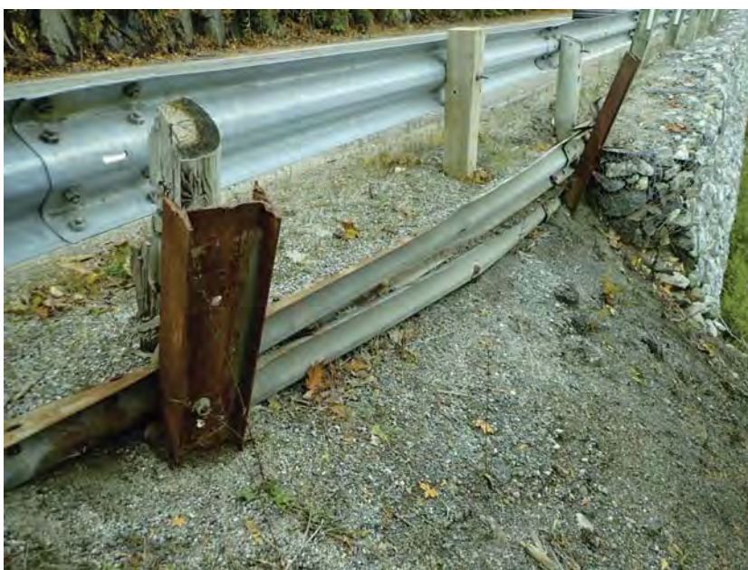
Figure 4 : Inclinaison négative de la section 2 (localement instable)
