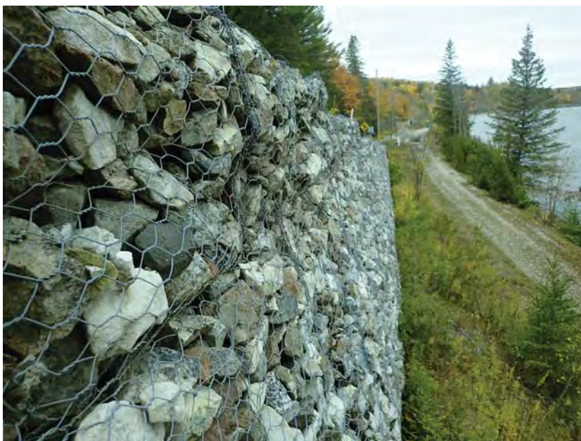
Figure 1 : Inclinaison positive de la section 1 du mur (globalement stable)
