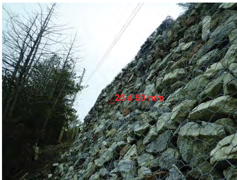
Figure 2 : Porte-à-faux du sommet au sud de la section 1 (possible zone d'instabilité locale)
