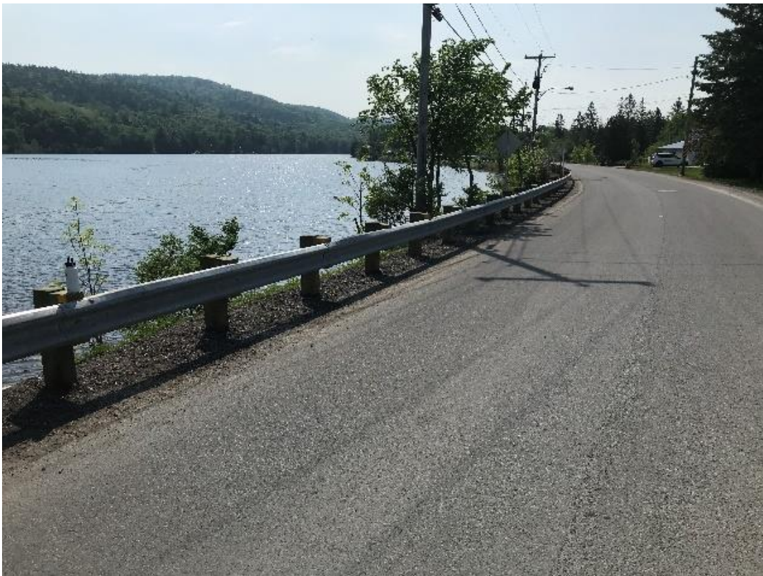
Figure 9 Vue de la route longeant la rivière. La route entre en conflit avec les baigneurs.
